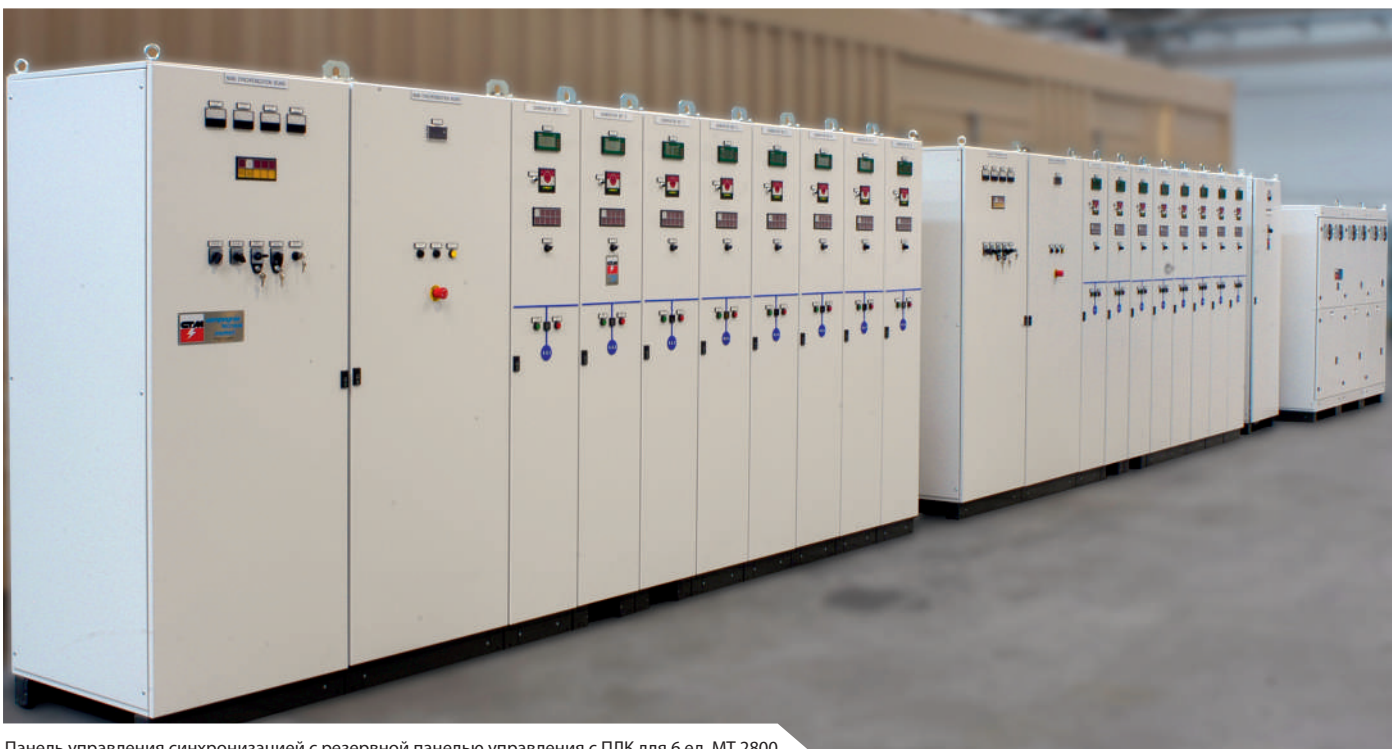
Панель управления синхронизацией с резервной панелью управления с ПЛК для 6 ед. МТ 2800
